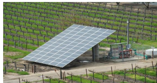
Fig. 3.5 Vedere panou fotovoltaic si generator electric pentru asigurarea apei de irigatie la o plantatie de vita de vie [203, 204]
