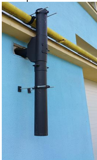
Fig.8 Instalație pentru epurarea gazelor
