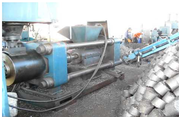
Figura 3.9. Instalație de brichetare așchii metalice
