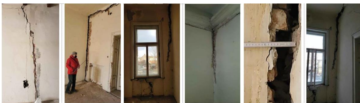
Figură 34. Avarii identificate la nivelul pereților din zidărie [54]
