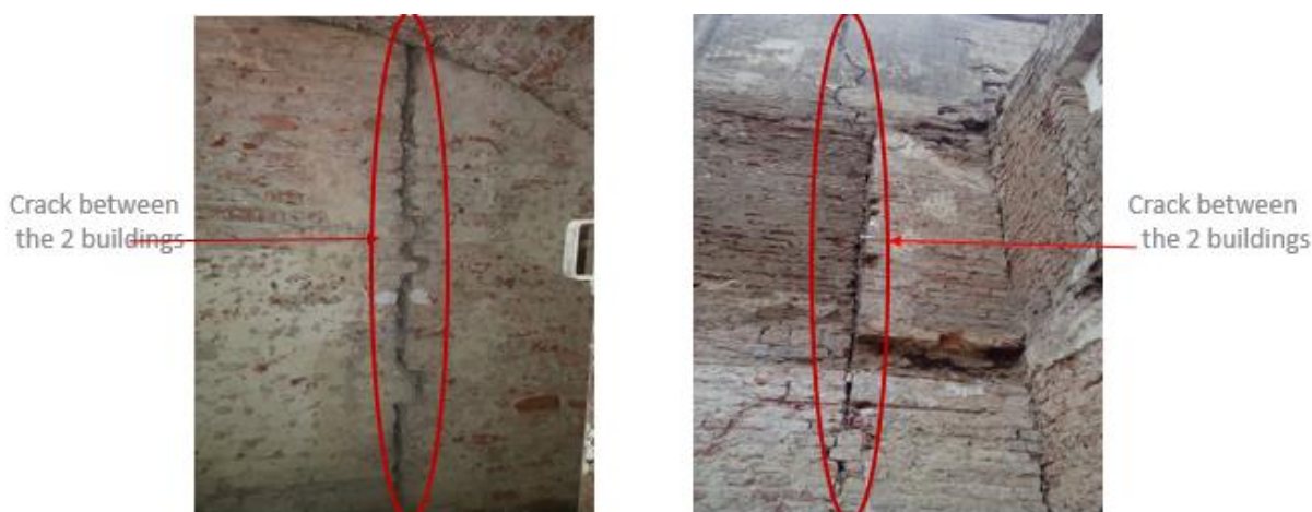
Figură 12. Fisuri identificate la nivelul pereților din zidărie
