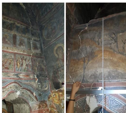
Figură 25. Avarii și fisuri identificate în urma inspecției vizuale la nivelul pereților, în interior [50]
