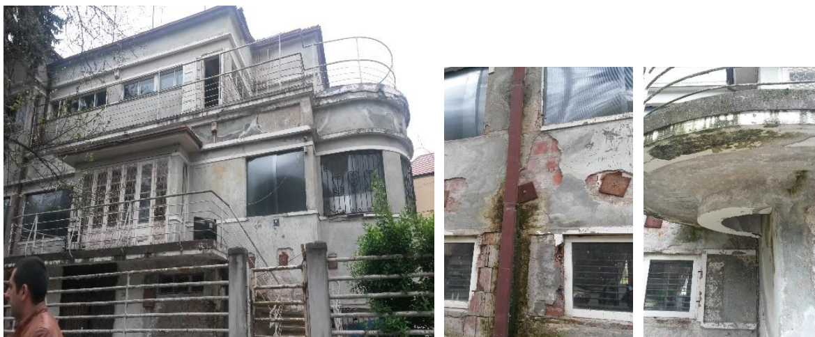
Figură 14. Nivelul de degradare exterioară [48]
