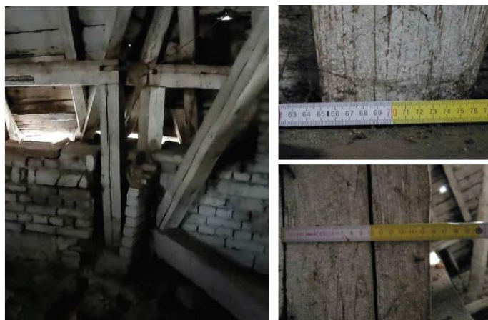
Figură 35. Avarii identificate la nivelul șarpantei [54]
