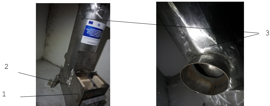
Figura 4.3. Centrala termică pilot: 1-tub de alimentare, 2-focar, 3-corpul centralei
