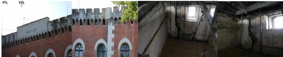
Fig 1. Semne vizibile de deteriorare
