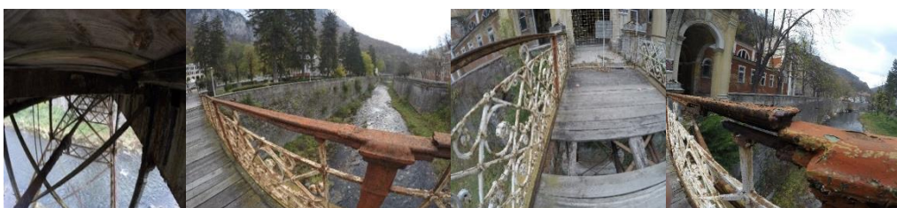
Fig 7. Gradul de degradare al podului
